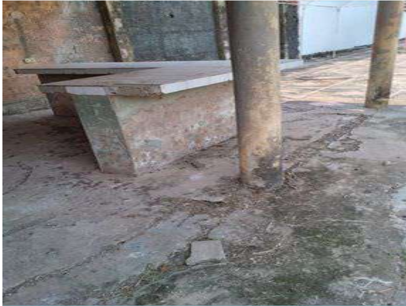
DETERIORO DE COLUMNAS
